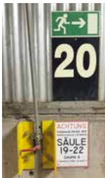
Handauslösung Sprühflutanlage / PM4-Löschanlage
