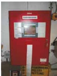
Hauptzentrale in Kesselhaus - Schaltwarte
