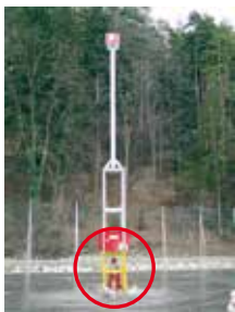
Hydrant und Schlauchkästen im Bereich AP-Platz
