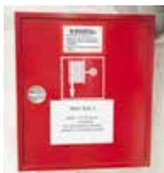
Wandhydrant inkl. Spritzrohr und Schlauch (30 m)
