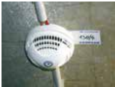
Opt. Rauchmelder, Wärmediff.melder (AUTOMATISCHE DETEKTION)
