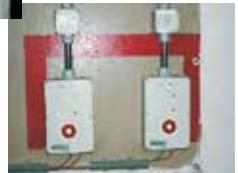
Rauchansaugsystem (RAS) (AUTOMATISCHE DETEKTION)
